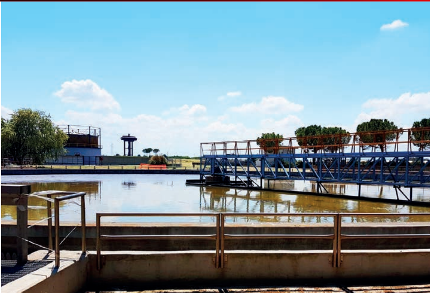
ESTACIÓN DEPURADORA, ITALIA, 2.500 M 2
