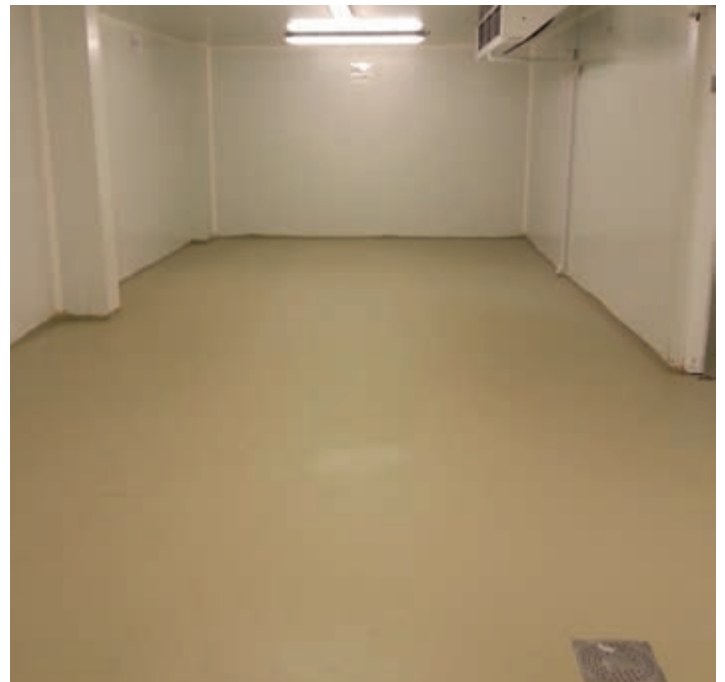
SALA REFRIGERADA DE PROCESO, FRANCIA, 1.400 M 2
