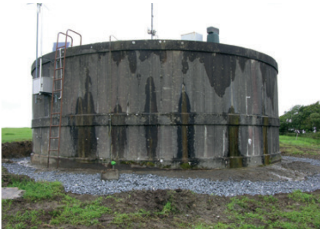
Gran depósito de agua potable con fugas antes y después del tratamiento con resinas impermeabilizantes de Krypton Chemical.
